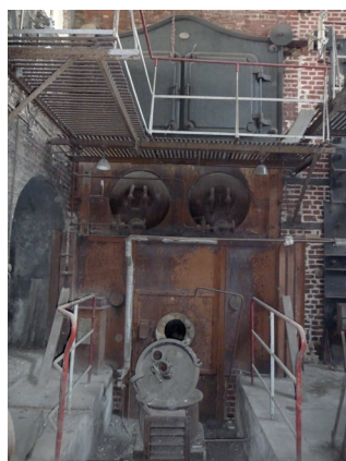
Vue des trois chaufferies de l'usine, © Service Patrimoine
